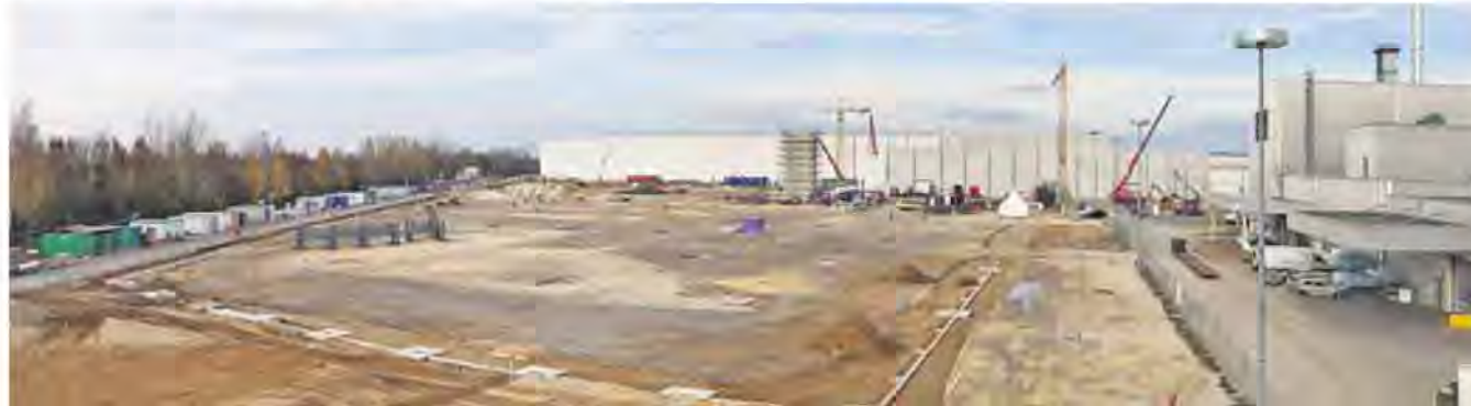
Neues für die Region: Während bei Audi im neuen Ingolstädter Werk bereits riesige Roboter-Reihen A3-Modelle bauen, wird die neue Halle von BMW im Regensburger Osten in knapp einem Jahr fertig sein. FOTOS: STEFAN WARTER/OH, UWE MOOSBURGER/OH
